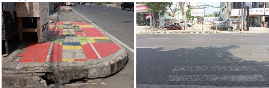
(c) Tidak Adanya Infrastruktur Disabilitas dan Marka Jalan Tidak Jelas
